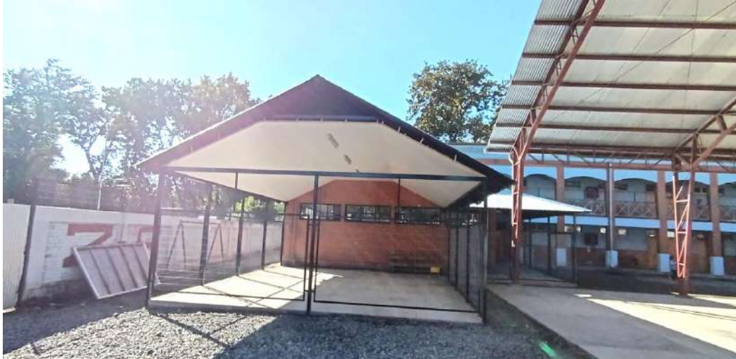
Liceo anexo Juan de Dios Puga, construcción de un patio cubierto exclusivo y con acceso independiente para párvulos.
